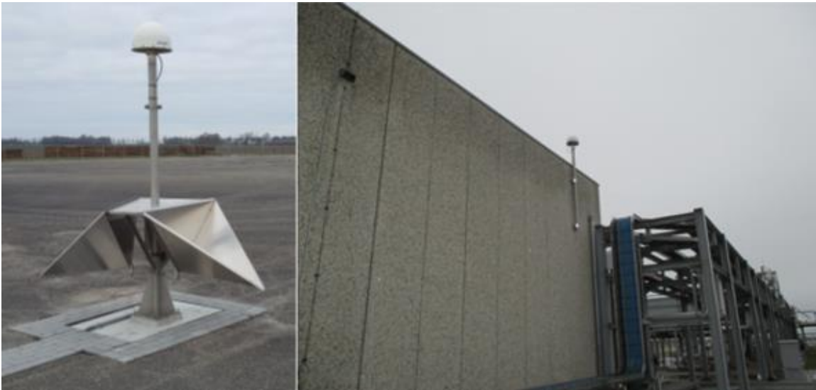
Figuur 2: IGRS-station (links) en GNSS-station bevestigd op een gebouw op een NAM locatie ('t Zandt).
